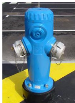
Poteau d'aspiration à réseau sec de Ø150 mm muni de deux sorties de Ø100 mm sans volant ni carré de manœuvre.
